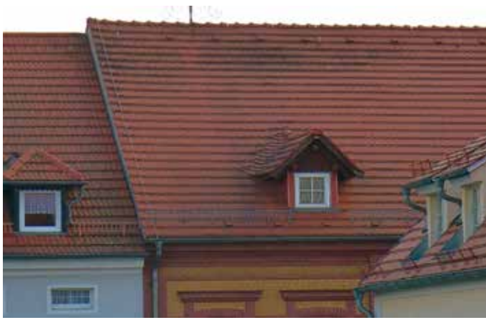
Abb. 1a, 1b: Angaben für maximale Dachüberstände an Traufen und am Ortgang (links. Typische Dachform ist das symmetrisch aufgebaute Satteldach mit Tonziegeldeckung in rötlich-braunem Farbton (rechts).
